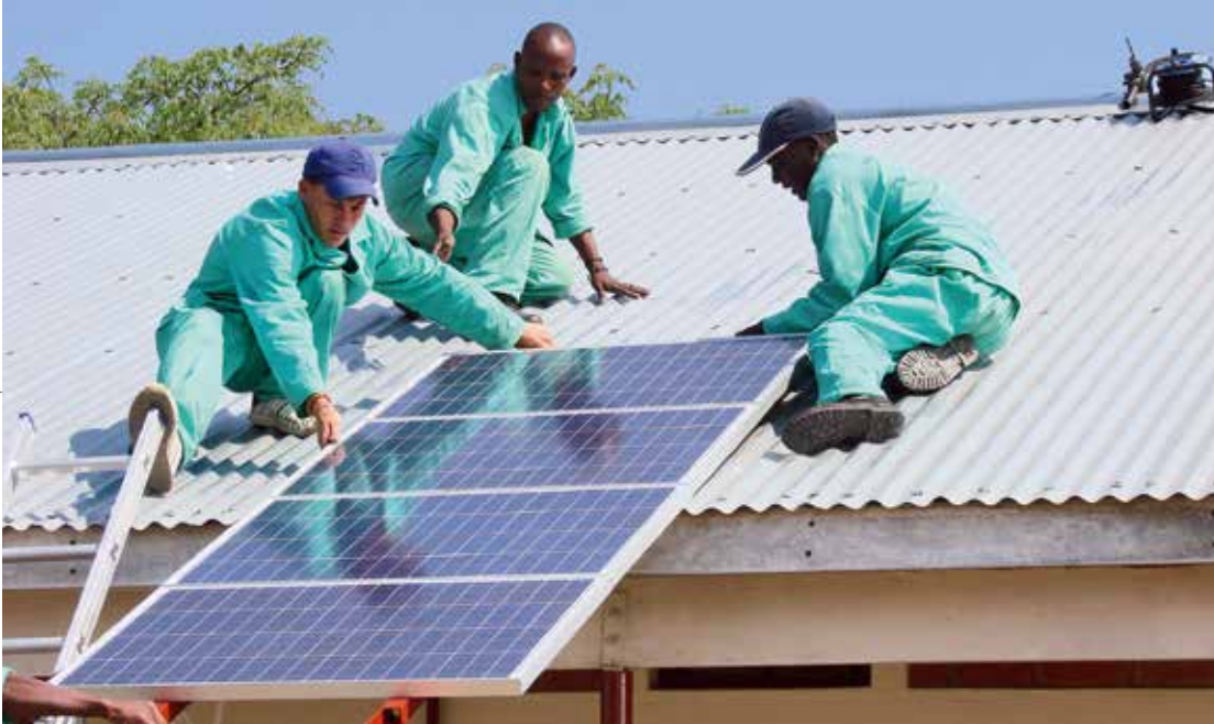
◀ Missionsdominikanerinnen: Auf dem Dach des St. Theresa's Hospitals in Charandura, Simbabwe, wird eine Solaranlage installiert. © Kloster St. Dominikus, Strahlfeld
